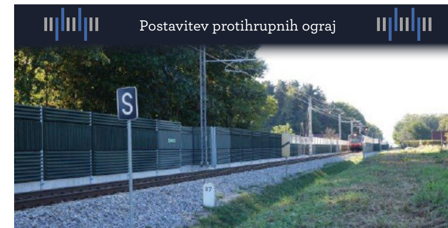
Postavitev protihrupnih ograj na odseku železniške proge pri postajališču Strnišče. Lepo so vidni tudi vodi za električno napeljavo, ki so sestavni del elektrificirane železniške proge.
